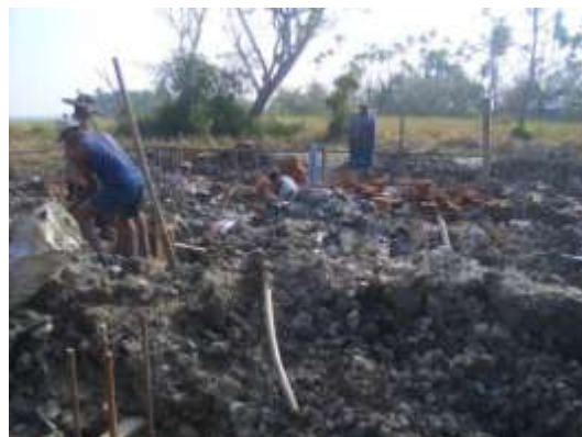
写真8 視察地(ミヤツタルウト村) 沿岸地域対応型学校建設の基礎工事現場
